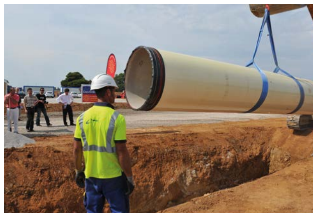
Enfouissement des tuyaux du réseau Aqua Domitia, Maillon SUD - sécurisation du Réseau Hydraulique Régional.
